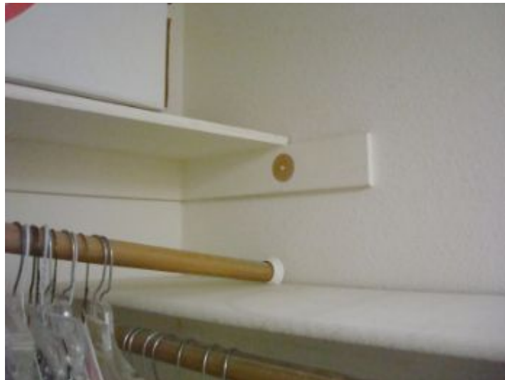
Rod end broken
